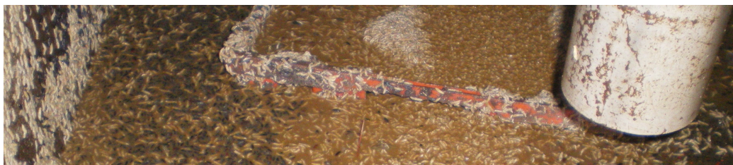
FIGURE 26 – Faune active à l'intérieur de la fosse Biofilcom
